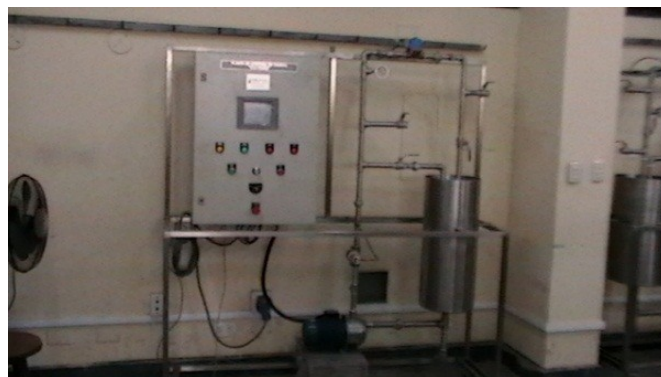
Figura 17.12: Módulo de Control de Caudal
