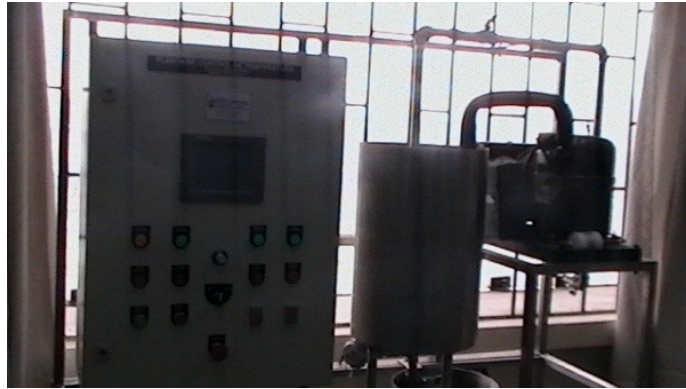
Figura 17.13: Módulo de Control de Temperatura
