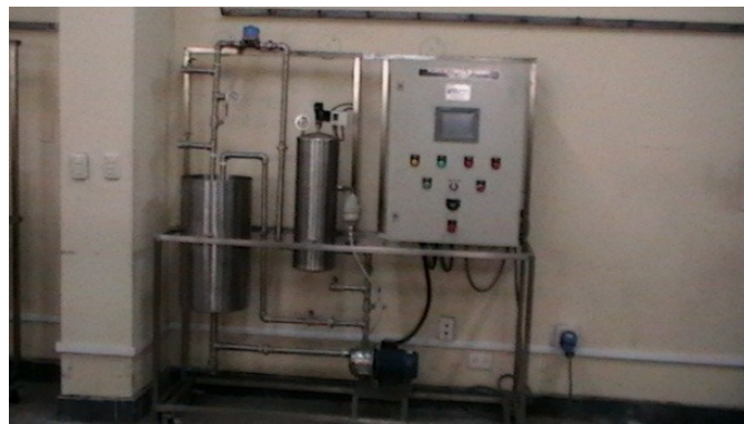
Figura 17.11: Módulo de Control de Presión
